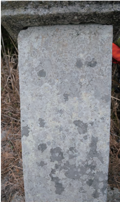
[사진13] 해풍부식이 심한 허계비 정면
